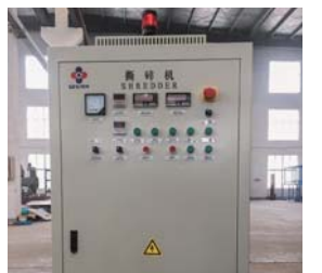
电气系统、PLC自动控制 Electrical system, PLC automatic control.
